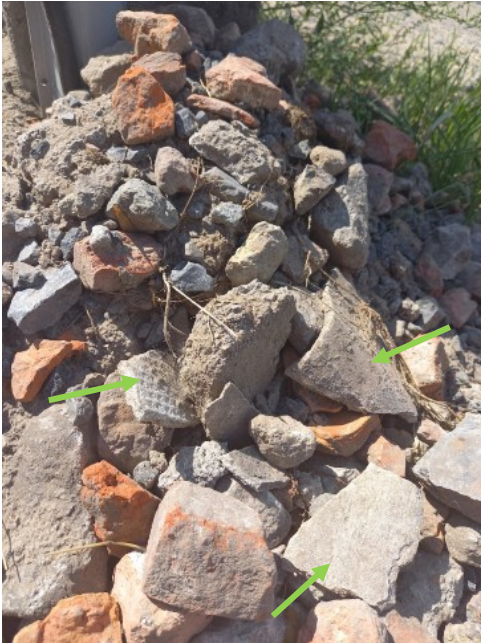
Figuur 52: Voorbeeld van opliggende resten in vezelcement op steenpuinlaag
