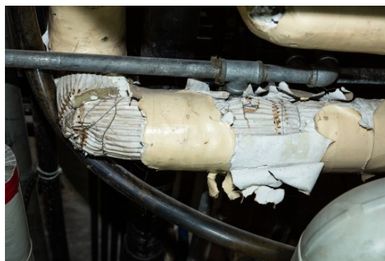
Figuur 51: Voorbeeld van thermische leidingisolatie in gips
