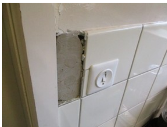
Figuur 2: Voorbeeld van tegellijm achter faience tegels die in normale omstandigheden niet-waarneembaar is. De tegellijm is hier wel waarneembaar door de bestaande opening (beschadiging van de tegels).
