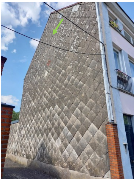
Figuur 58: Voorbeeld van verweerde gevelleien in vezelcement
