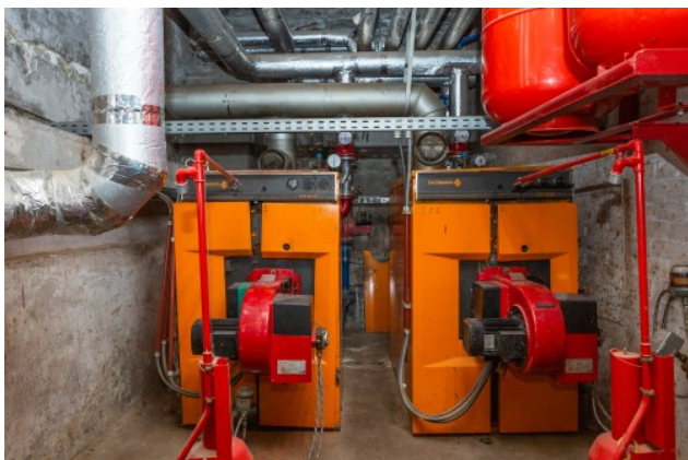
Figuur 28: Voorbeeld van een stooklokaal met stookketels
