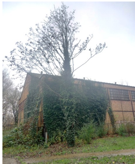
Figuur 32: Voorbeeld van overwoekerende vegetatie aan gevels
