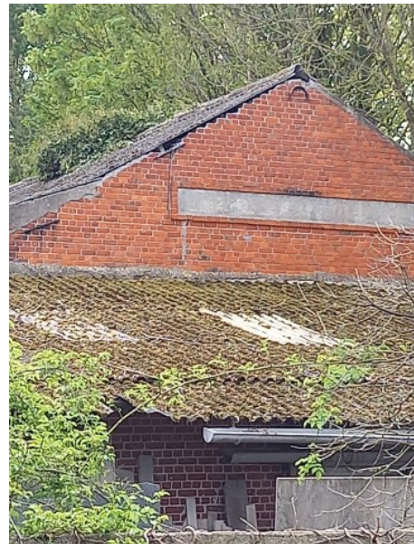
Figuur 59: Voorbeeld van verweerde golfplaten in vezelcement
