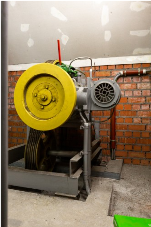
Figuur 37: Liftmachine: uit het onderhoudsdocument, dat als bewijsdocument geldt, staat dat de remschoenen vervangen werden in 2016
