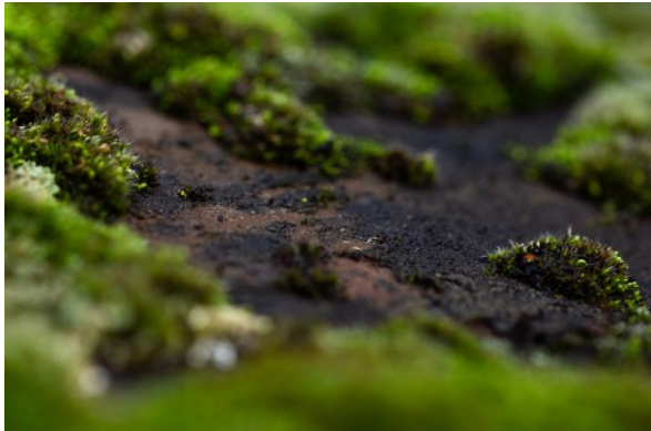
Figuur 56: Voorbeeld van vrijkomende chrysotielvezelbundels door degradatie (mos) van leien in vezelcement
