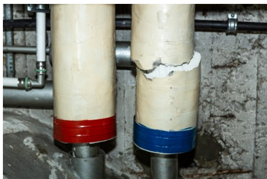
Figuur 50: Voorbeeld van thermische leidingisolatie in gips
